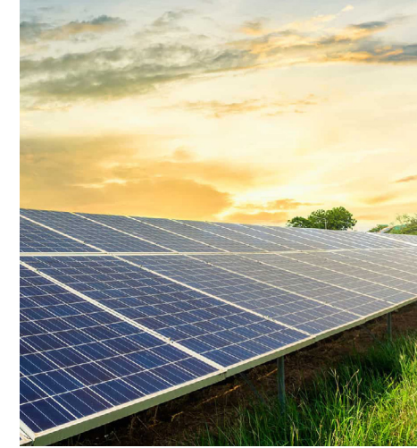
مشروع الشعيبة للطاقة الشمسية Al-Shuaiba Solar Power Plant Project
